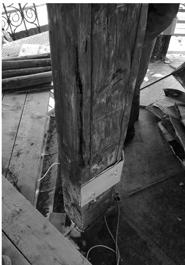
8. ábra: Károsodott ötszögletű oszlop a harangterasz szinten
