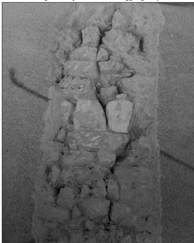
9. ábra: A hengere toronyrész falazatának függőleges repedése
